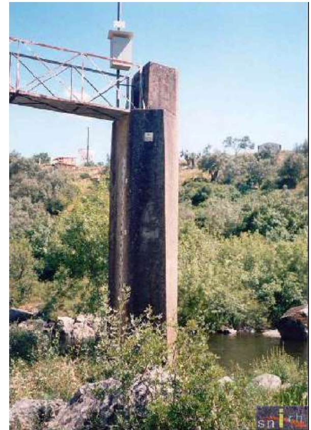
Estação hidrométrica para medição do escoamento
