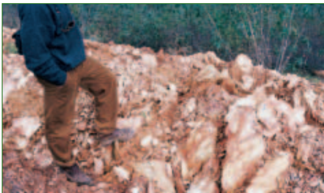
Figura 4 – Vala e câmoreo excessivamente profunda com carreamento de materiais pedregosos para a superfície do terreno
